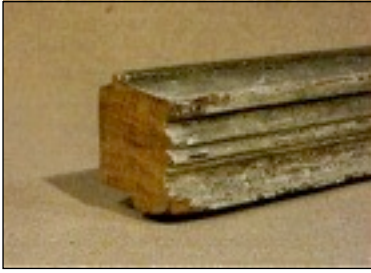
Die traditionelle Konservierung mit Leinöl an diesem unteren Rahmenholz eines historischen Fensters wurde vernachlässigt, ohne dass die Holzsubstanz Schaden genommen hat.
